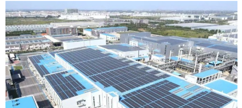
SK아이이테크놀로지 사업장 지붕 태양광 발전 설치
