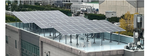
울산공장 태양광 발전시설
