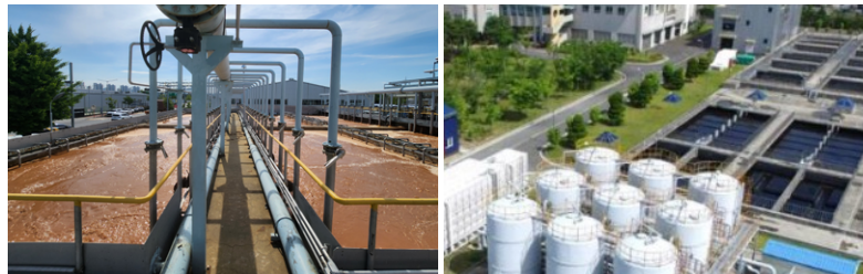
1. 울산공장 폐수처리장 2. 울산석유화학단지 용암 방류수 재이용 시설
