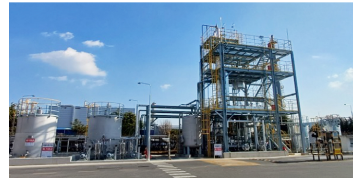
울산공장 내 재활용 EG 정제소 전경
