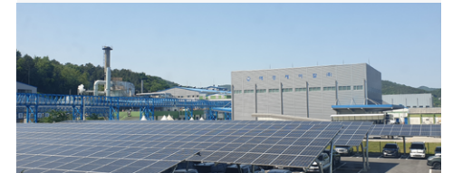
청양공장 태양광 발전시설
