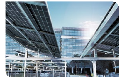
KB증권 연수원 내 태양광 발전설비
