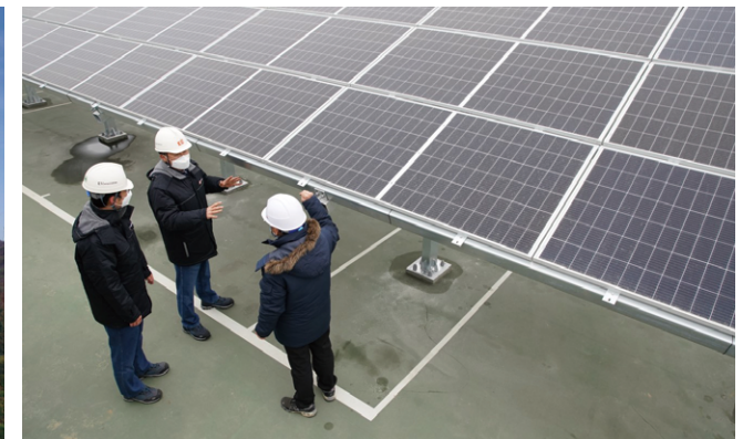
인천기지 태양광 발전소
