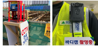
CCTV 상시 촬영
