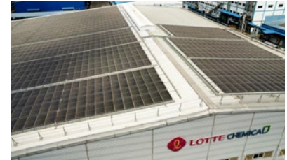
첨단 소재 베트남 태양광 발전 설비
