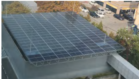
태양광 발전설비 설치 후 전경
