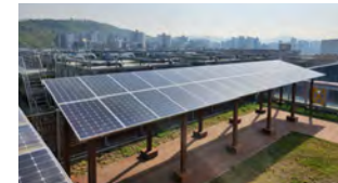
상암 데이터센터 태양광 발전시설
