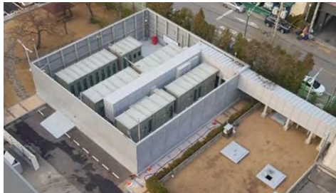
기존 옥외 수배전실 전경
