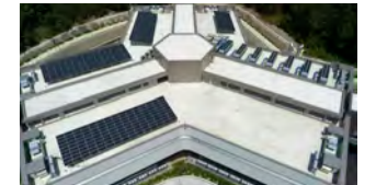
춘천 데이터센터 태양광 발전시설
