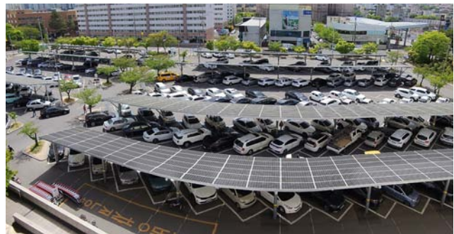
롯데마트 태양광 설비
